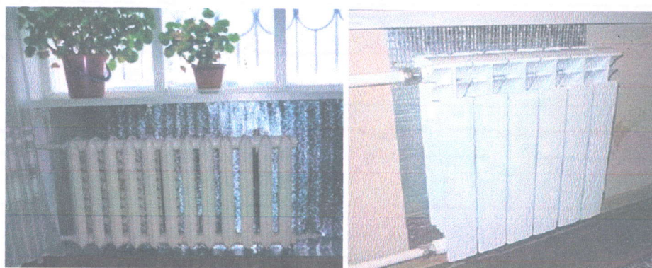
Рисунок 7. Отражающая теплоизоляция, установленная за радиатором отопления
